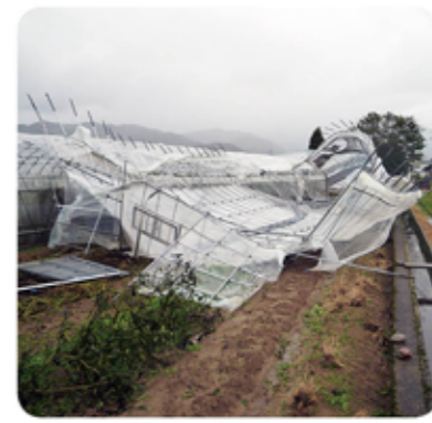
台風で倒壊したハウス H29年10月 永平寺町
