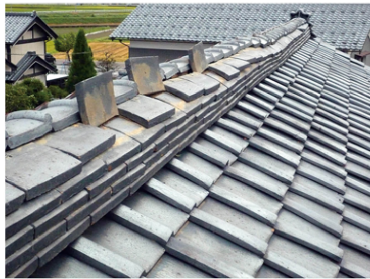
台風で破損した屋根瓦 H30年8月 大野市
