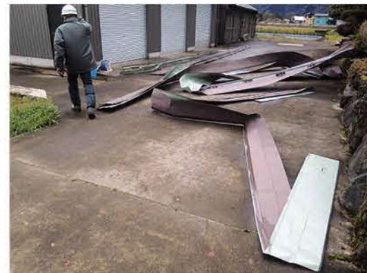
強風により農作業場のトタン屋根が破損
